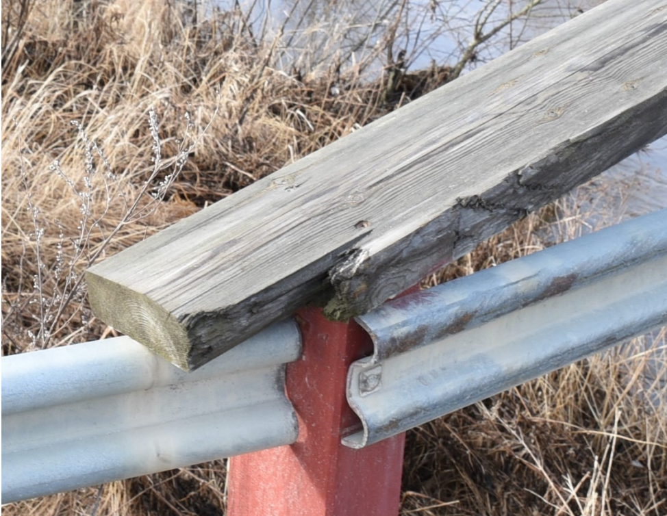
Fig 8. Skada 8, plogskador på toppföljare i NV, SO och SV ändar.
