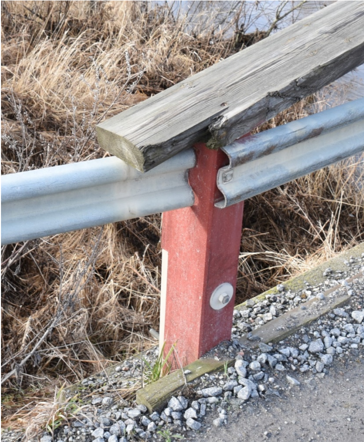
Fig. 6. Skada 5, Anslutning mot broräcke SO.
