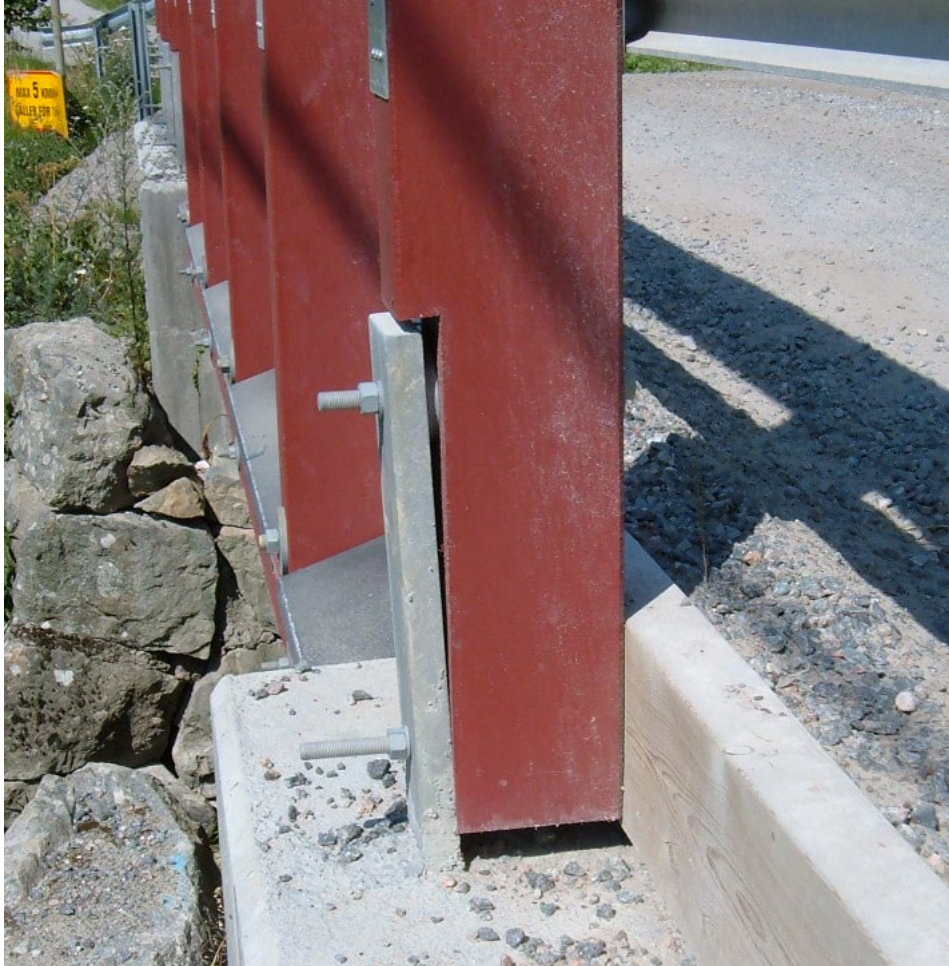
Fig. 3. Skada 3, distansbrickor mellan fäste och ståndare, bild från 2008.
