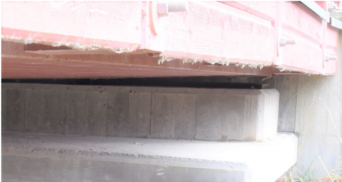
Fig 11. Skada 7, I SO hörn är glappet också drygt 30mm.
