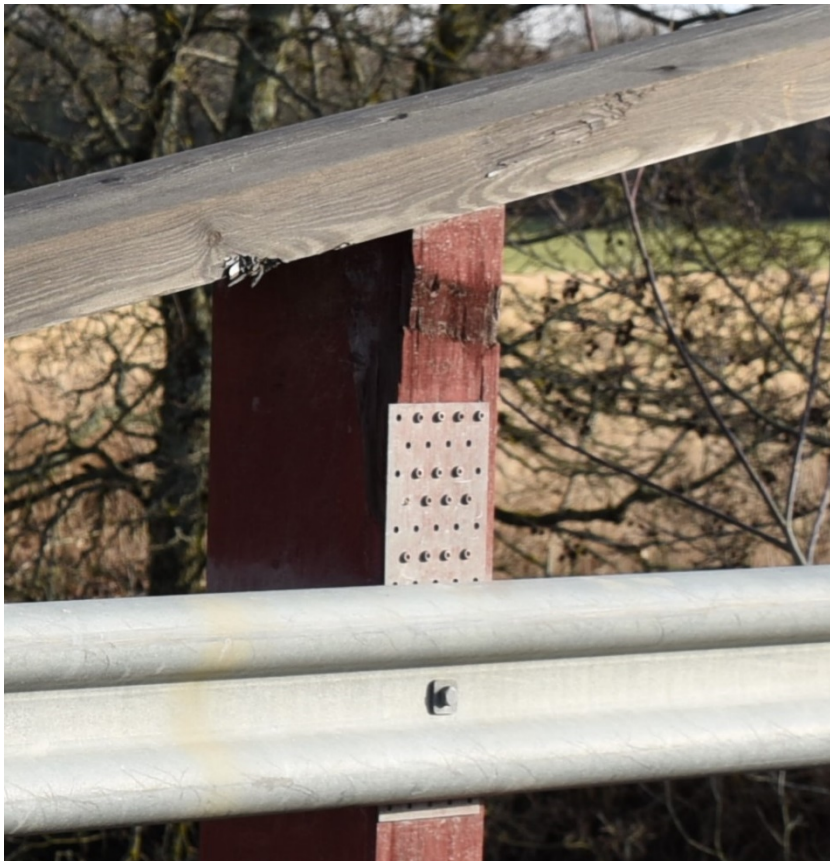
Fig. 2. Skada 2, är en korskada, mest troligt från plogning, bild från 2020.
