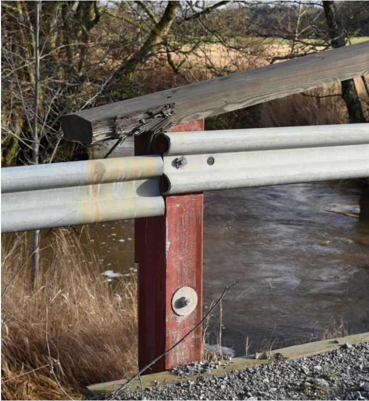
Fig. 4. Skada 5, Anslutning mot broräcke NV.
