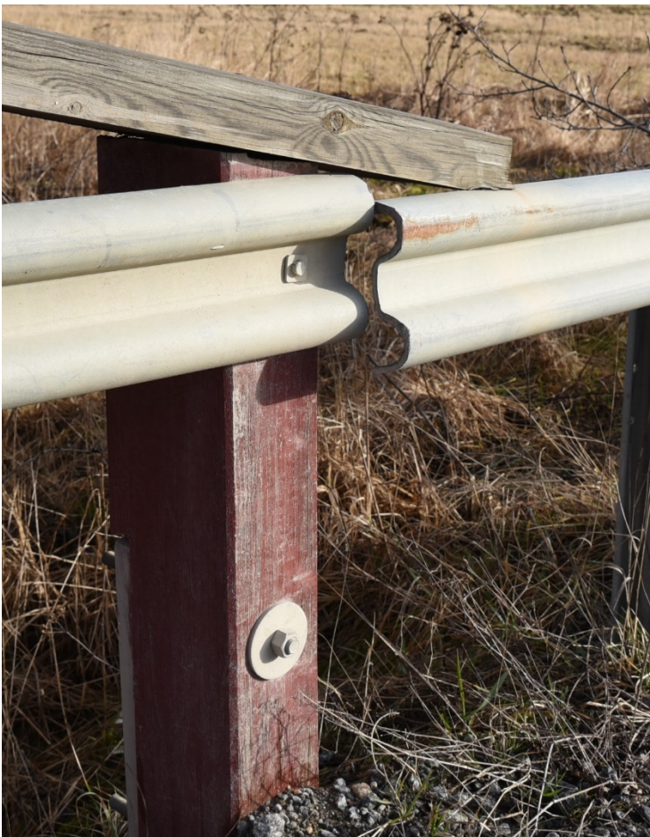
Fig. 5. Skada 5, Anslutning mot broräcke NO.
