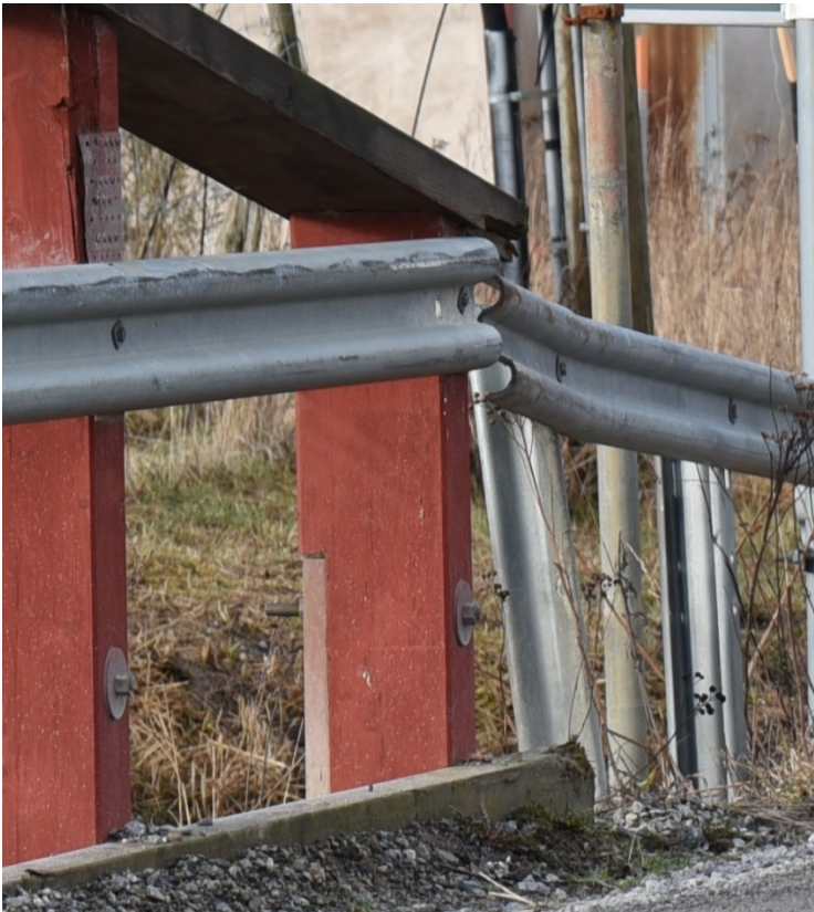
Fig. 7. Skada 5, Anslutning mot broräcke SV.
